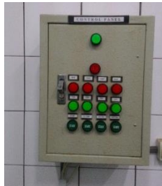
Gambar 5. Panel Kontrol Listrik
