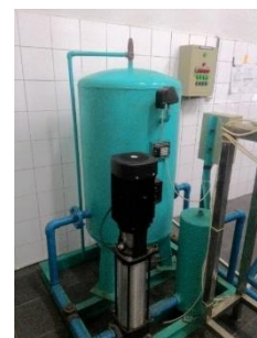
Gambar 4. Pompa Air dan Reservoir
