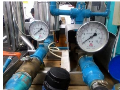
Gambar 3. Pressure Gauge Merek Forbes Berkapasitas 16 kg/cm 2 pada Water Meter Test Bench
